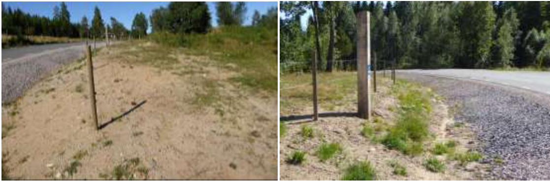
Figur 5 och 6. Samma östra väggkant som i Fig. 4 den 18 augusti 2015. De sandiga ytorna har blivit betydligt större.
